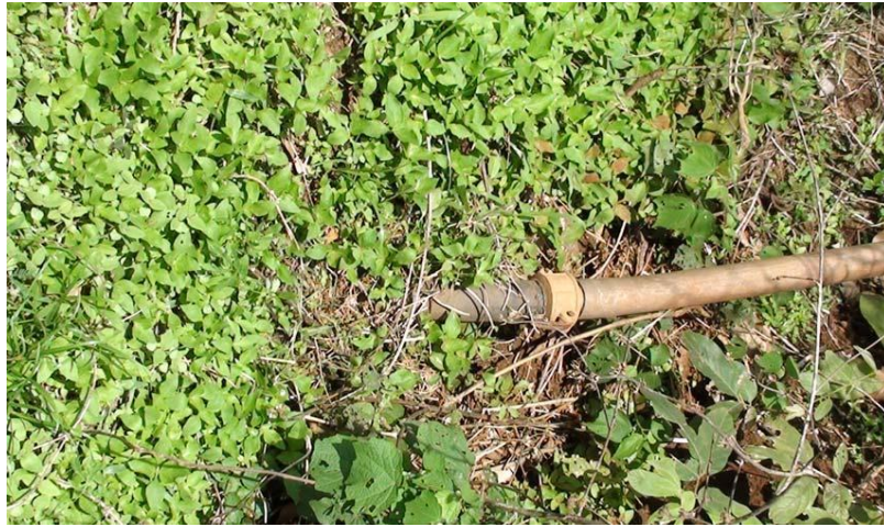
Hình 3.49. Hệ thống ống tưới chính được lắp đặt ngầm dưới đất
